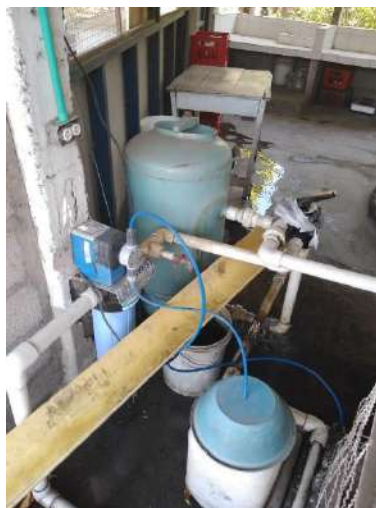
Planta de tratamiento de agua
